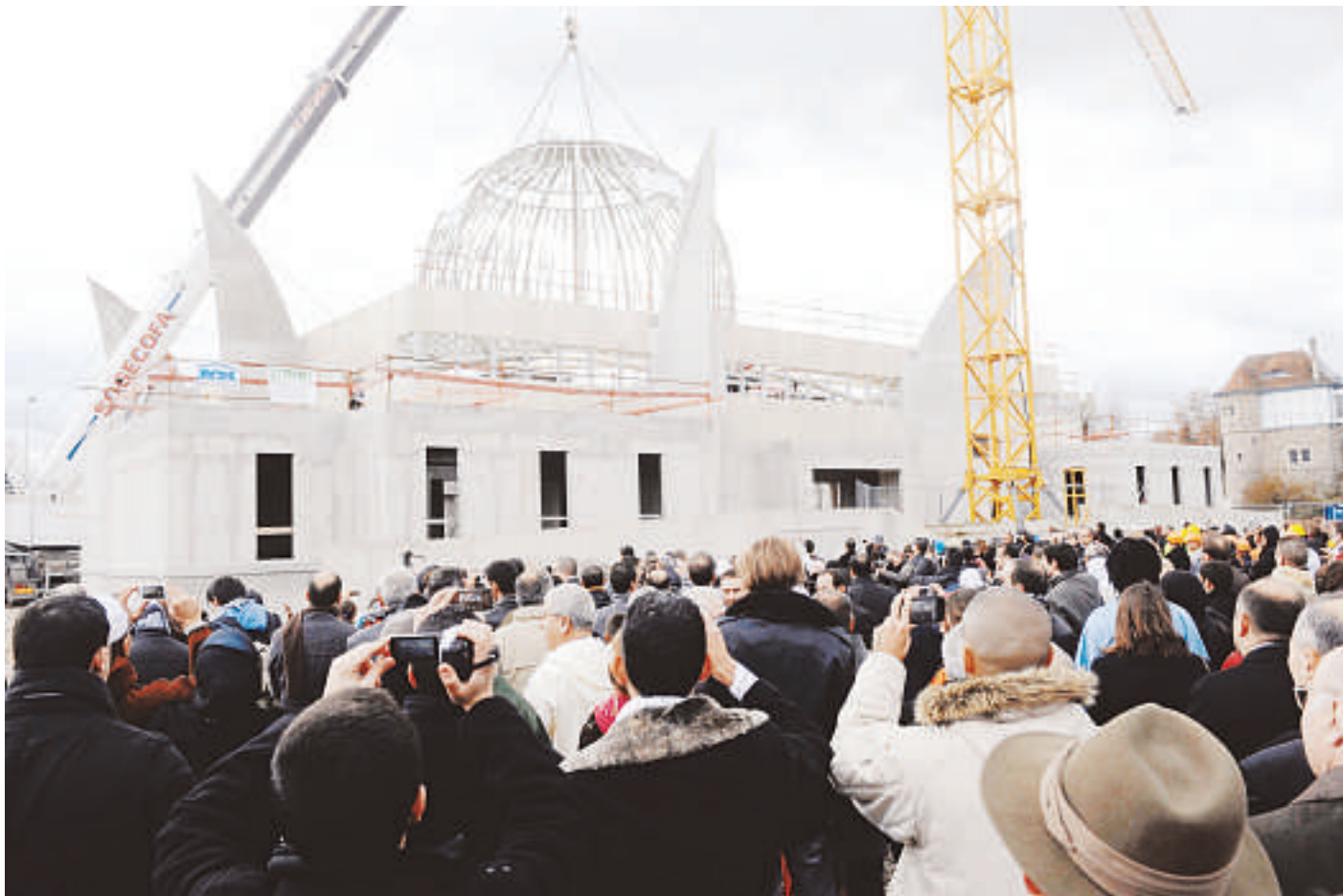
La coupole désormais en place complète l'architecture de la mosquée qui imbrique un carré (le bâtiment lui-même), un octogone (dessiné par les piliers) et un cercle (la base du dôme). (Photo DNA - Jean-Christophe Dorn)
